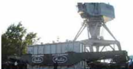
Сербия: трансформатор 400kV 400MVA
