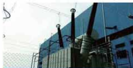
Индия: трансформатор 420kV 60MVA
