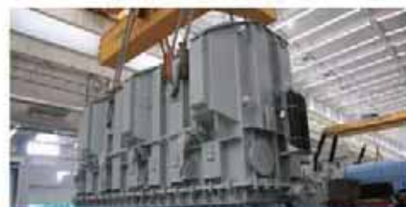
Пуэрто-Рико: трансформатор USA230kV 570MVA
