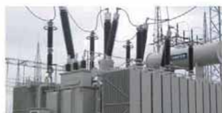
Эквадор: силовой трансформатор для CELEC S.A
