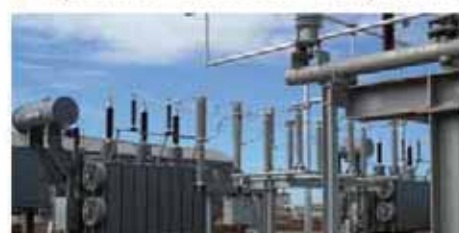
Австралия: трансформатор 132kV для ВНР
