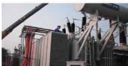
Бангладеш: силовой трансформатор для Aggreko
